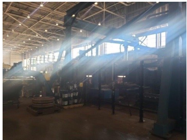
Equipo auxiliar — instalacion y conexion
